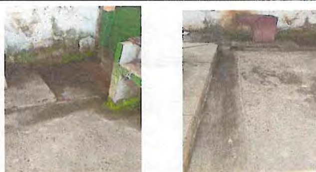
Foto 6: Cuneta y reposadera
